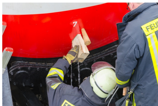
Abdichtung an Leckagepunkt
